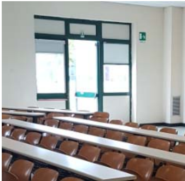
Una delle 4 uscite di emergenza a piano terra delle aule- Aula A
